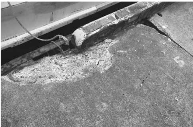
老朽化した漁港区の岸壁
