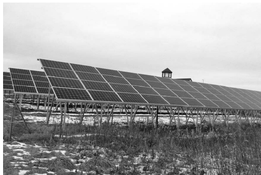
太陽光発電設備（社台地区）
