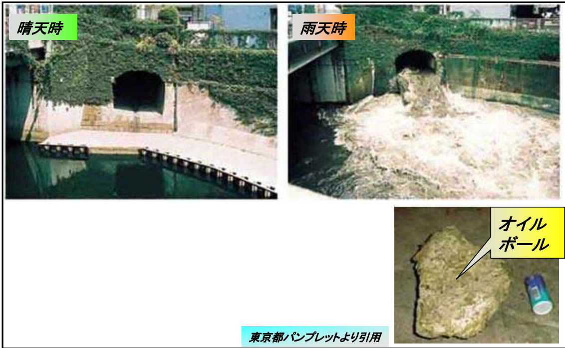
図 1.3 未処理放流水の越流状況
