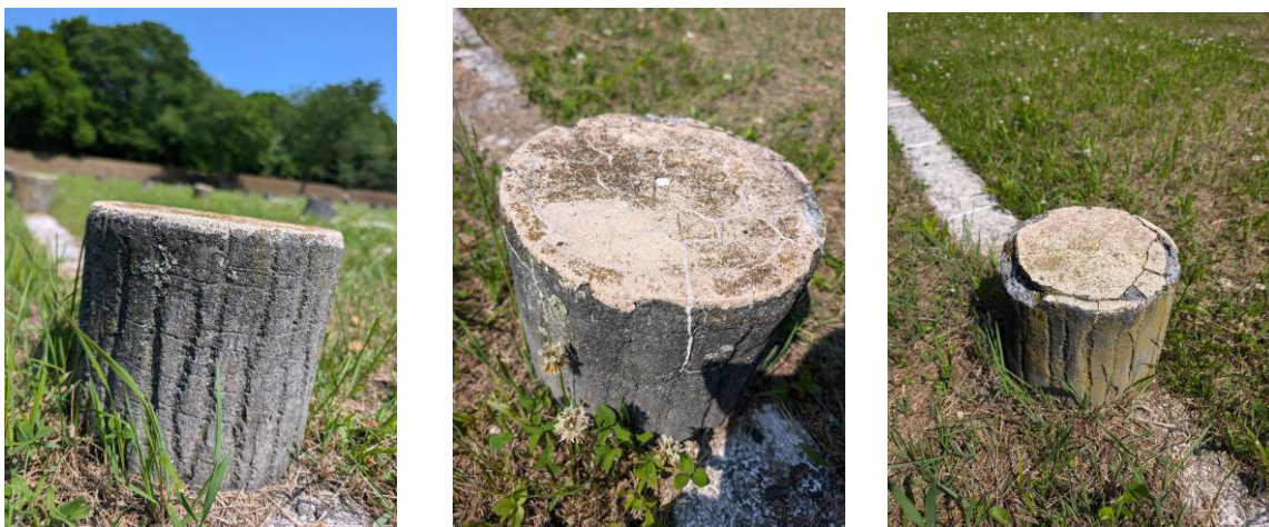
建屋跡の平面展示における石柱の現況。表層部からの剥離が生じている。
