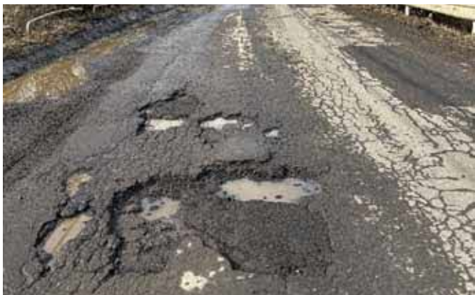
凹凸で早急に補修が求められる町道竹浦飛生線
