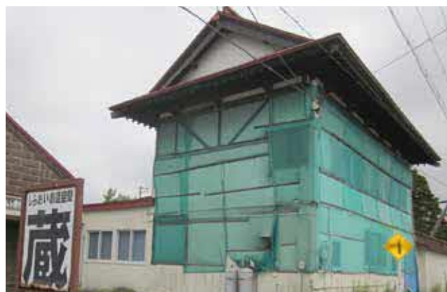
外壁が落下しブルーシートに覆われている南側の木造建物
